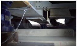
支承とジャッキ
