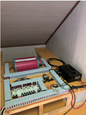
内部の蓄電ユニット
