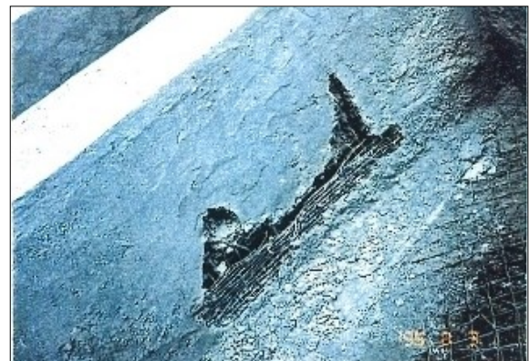
写真-5 縦梁に発生した鉄筋背面の空洞
