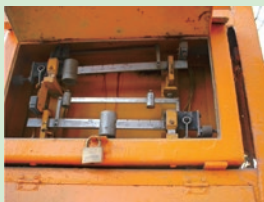
従来型計量器の調整箇所
