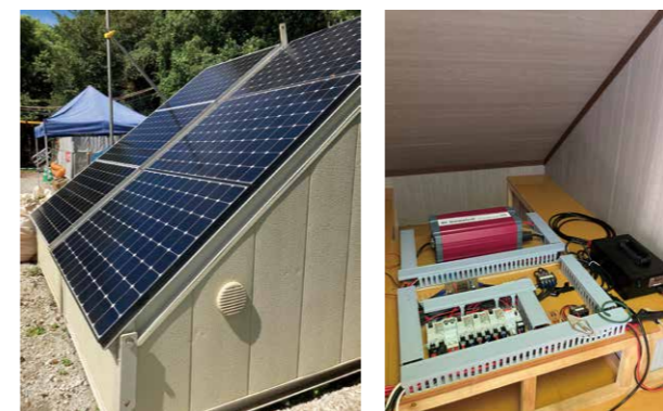
蓄電ユニット組み込み型の太陽光発電装置 内部の蓄電ユニット
