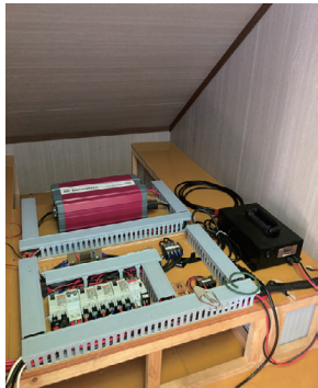
内部の蓄電ユニット
