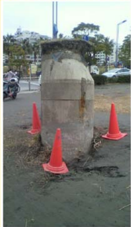
東日本大震災 被害状況
