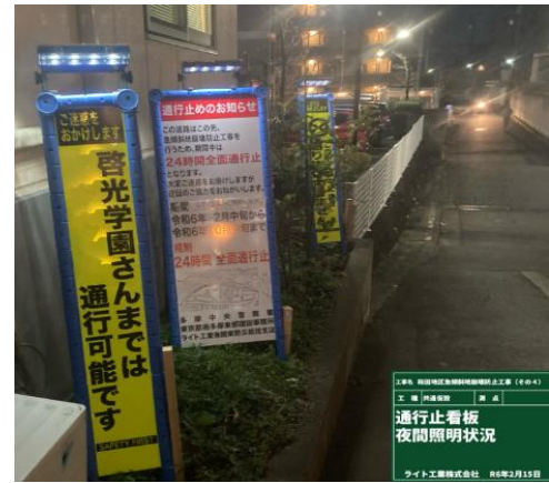
写真3. 看板夜間照明（太陽光発電）
